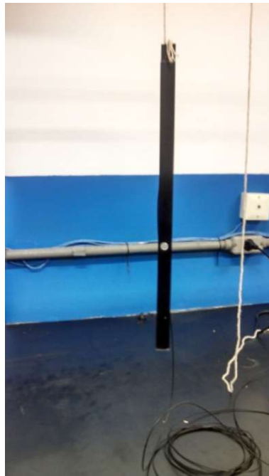
Figura 19 - Ilustração da estrutura danificada com um furo
