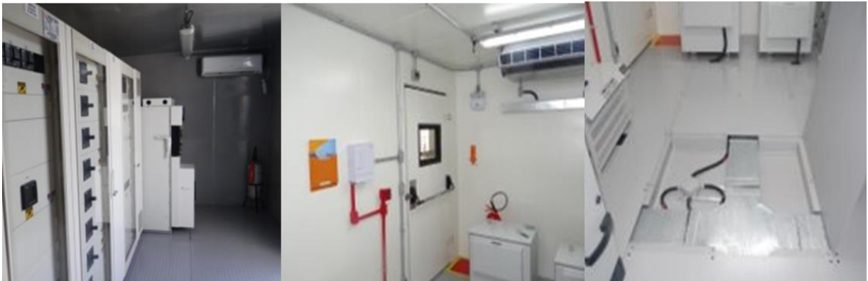
Figura 2.11 – Circuitos distribuídos em Eletrocentros instalados
