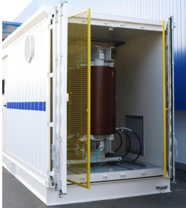
Figura 2.12 – Baia do transformador em Eletrocentro instalado
