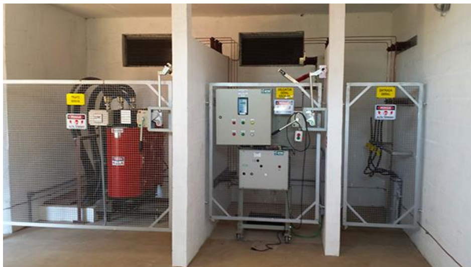
Figura 2.3 – Subestação abrigada em alvenaria até 36 kV
