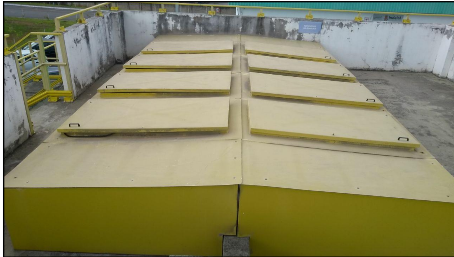
Figura 8 - Caixa de Gordura Não Utilizada.
