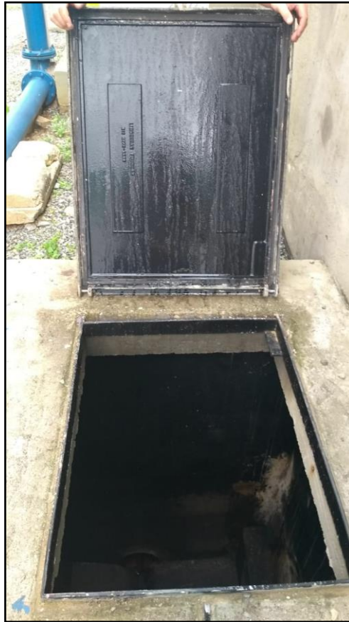
Figura 20 - Tampas de Alumínio do Sistema Danificadas.
