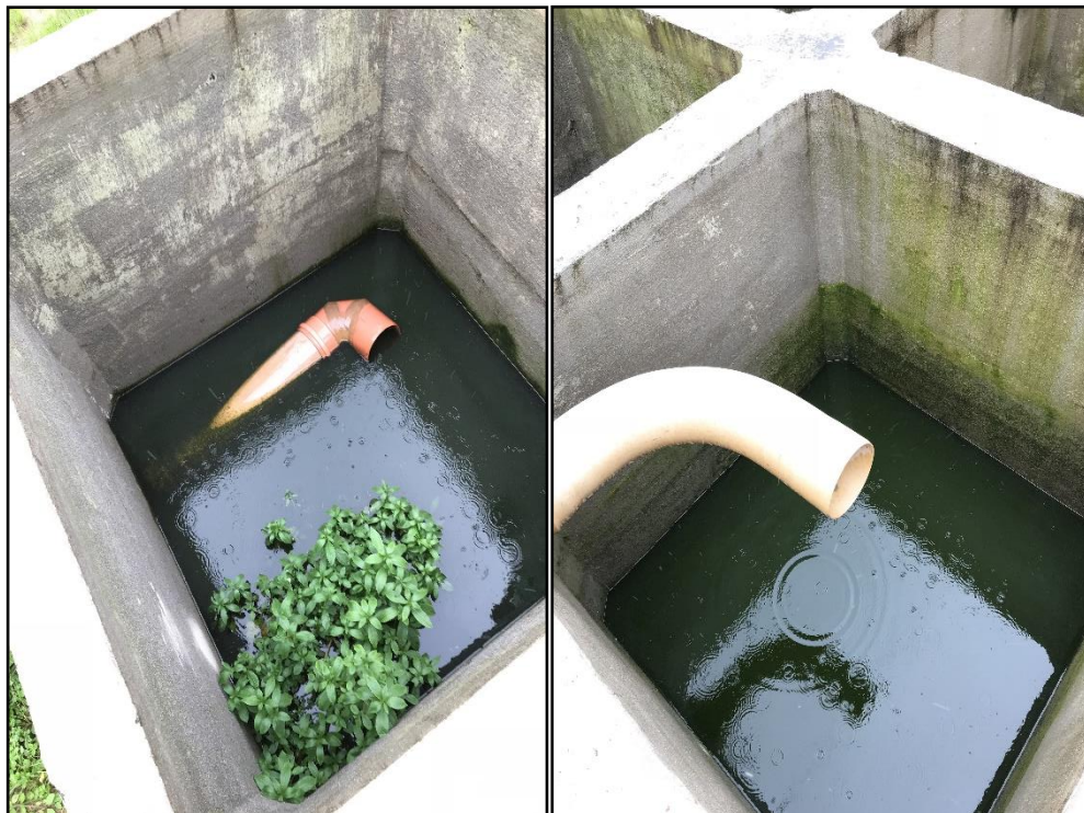
Figura 17 - Acúmulo de Água da Chuva e Sólidos no Tanque de Contato.
