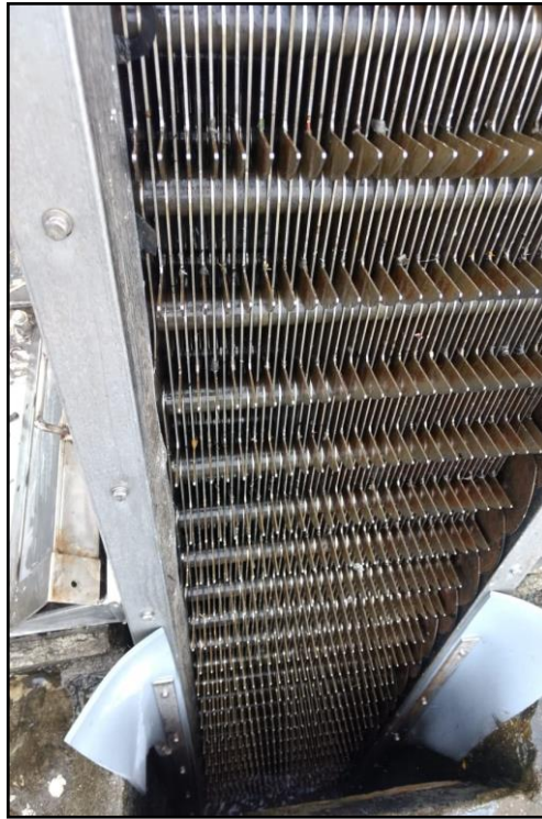
Figura 6 - Gradeamento Mecanizado e Anéis Laterais Rompidos.
