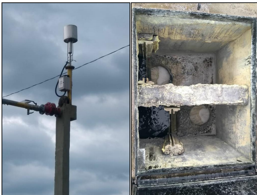
Figura 12 - Queimador de Gás e Estruturas Danificadas pela Produção de Gás.
