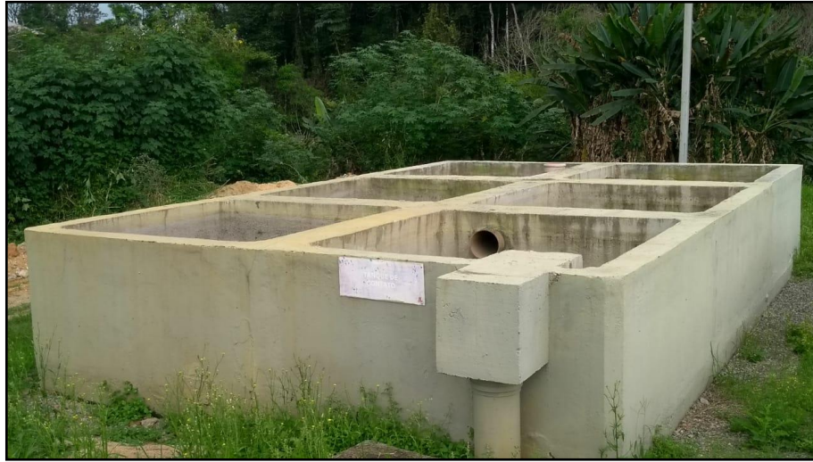
Figura 16 - Tanque de Contato.
