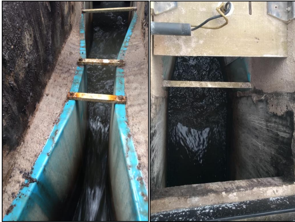
Figura 7 - Ressalto na Calha Parshall do Tratamento Preliminar.
