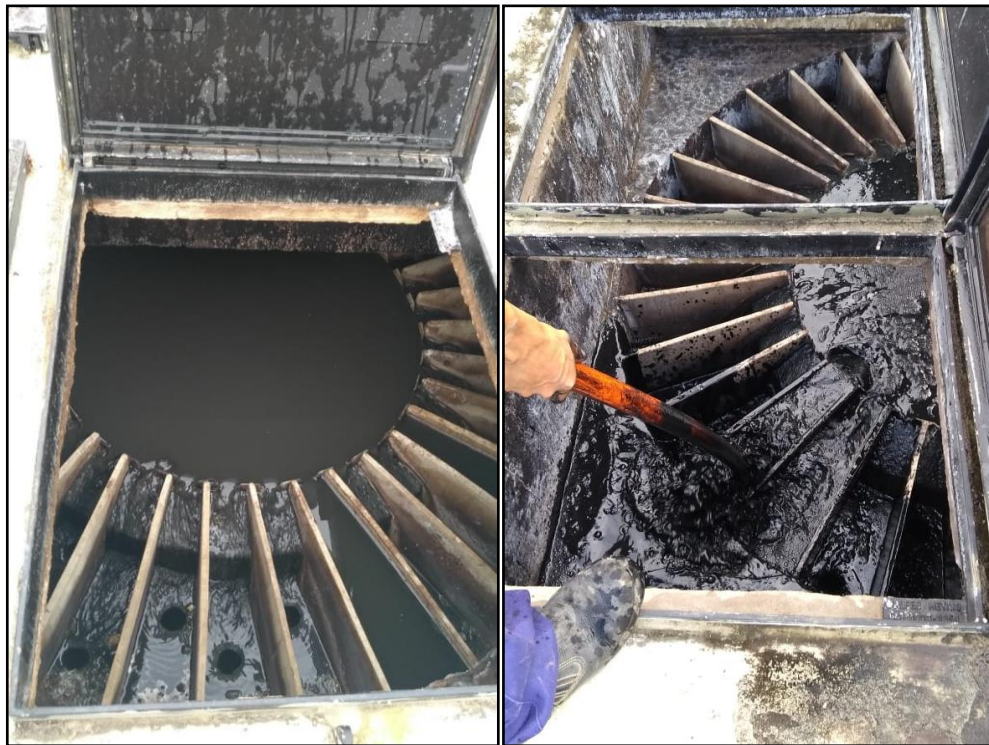
Figura 10 - Vertedores Entupidos do UASB.
