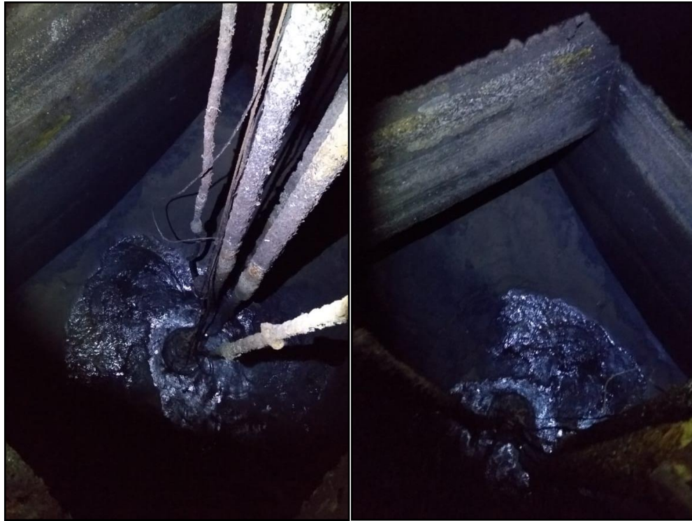
Figura 5 – Acúmulo de Sedimentos na Estação Elevatória de Efluentes.
