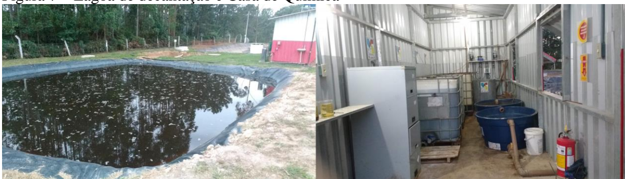
Figura 7 – Lagoa de decantação e Casa de Química
